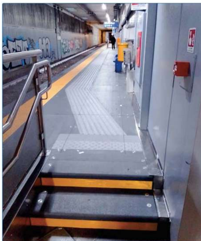
Fig. 2 - Banchina con percorsi tattili Loges installati
